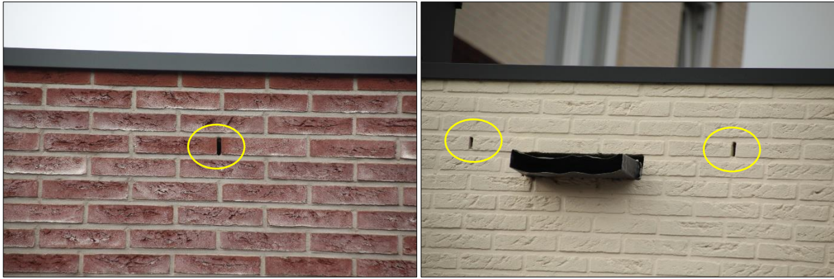
Open stootvoegen (gele cirkels) aangetroffen aan de gevels van het winkelpand.
