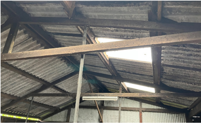
Afbeelding 5. Geen isolatie aanpalende schuur met ontbrekende dakdelen
